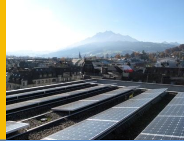
30.2 kWp, Luzerner Kantonalbank, Luzern
