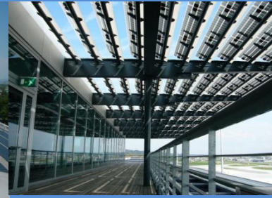
275 kWp Dock Midfield, Flughafen Zürich
