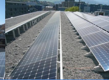
35 kWp, Schurter AG Luzern
