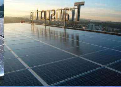
51 kWp, Transportus AG, Luzern
