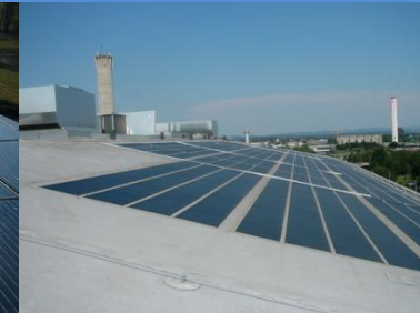
25.3 kWp Schulhaus Leutschenbach, Zürich
