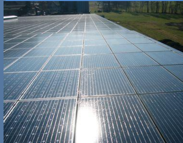
538 kWp Affentranger Bau AG, Altbüren
